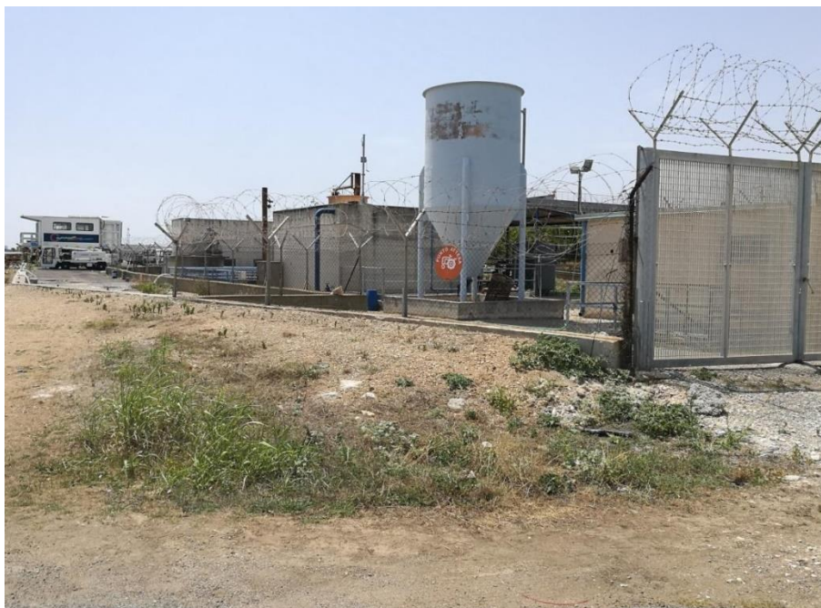
Figura 7-16 Impianto di trattamento esistente
