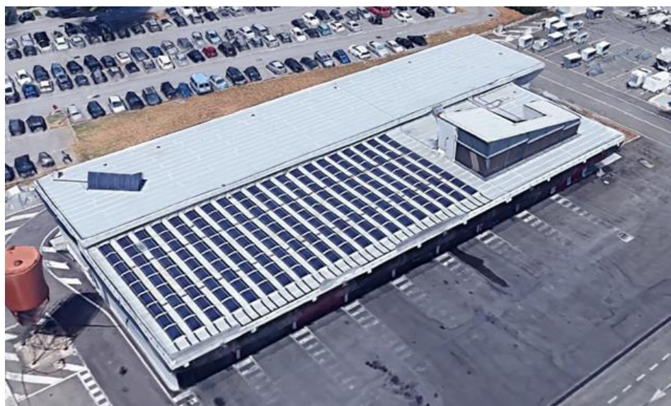
Figura 7-19 Impianto fotovoltaico n.2 posto sulla copertura della caserma dei Vigili del Fuoco
